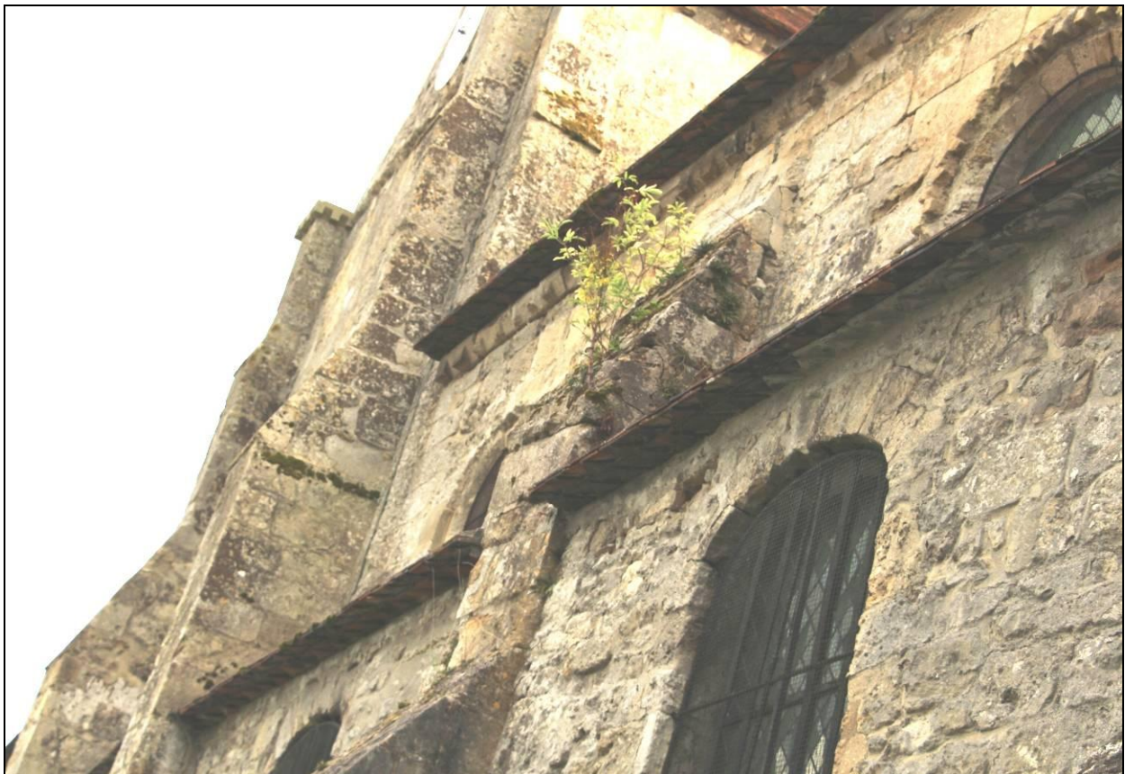
Le contrefort du milieu a un glacis en pierre de taille est très altéré, l'humidité pénètre dans les maçonneries et dégrade les parements des voûtes. La végétation se développe dans les joints..
