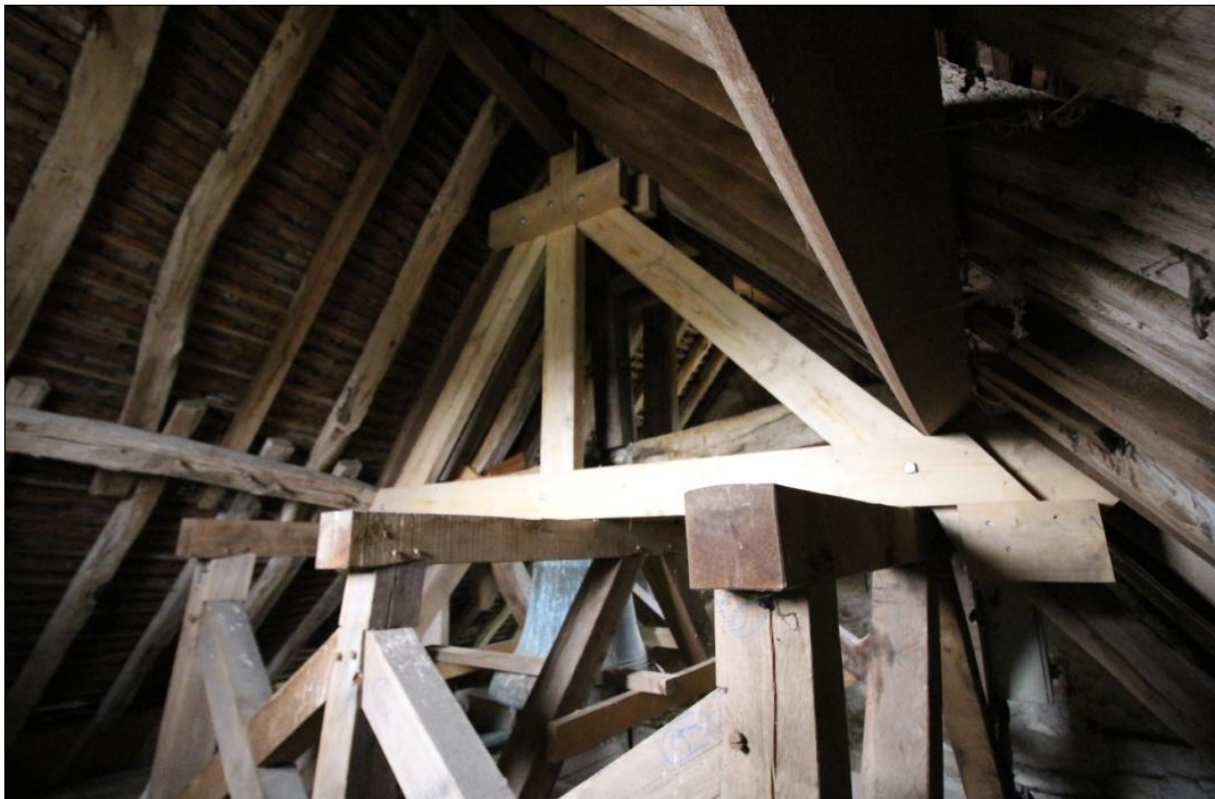
Etaiement de la charpente réalisé en novembre 2018 : deux fermes provisoires en appui sur le beffroi neuf, de part et d'autre de la ferme ancienne.
