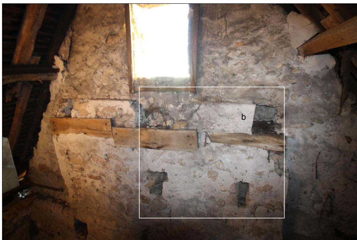
Mur Sud, en 2018: les empochements des chapeaux des fermes (b) autour de la cloche. Au-dessous, des empochements décalés : probablement pour des renforts obliques rapportés sur les fermes de part et d'autre de la cloche. Photo CG.
