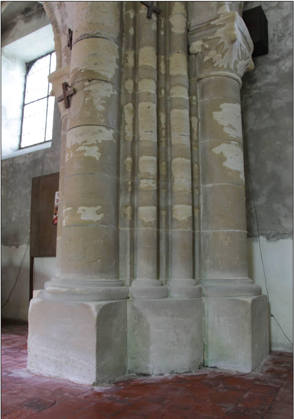
Altération des blocs sur fûts des piles Nord.
