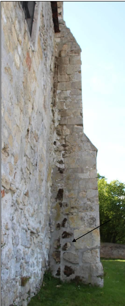
Dans l'angle du contrefort entre chœur et clocher, ciment à purger.
