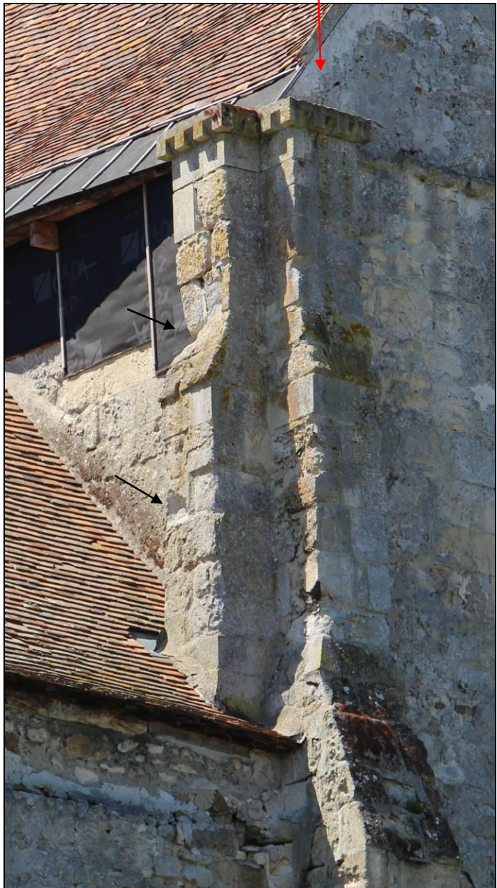
Blocs altérés sur contreforts Nord-Est du clocher. Blocs récents sur les assises les plus hautes et sur corniche.
