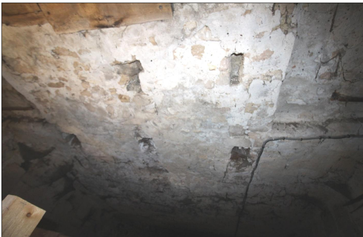
Mur Sud, en 2018 : les empochements des semelles du beffroi et de leurs jambes de force
