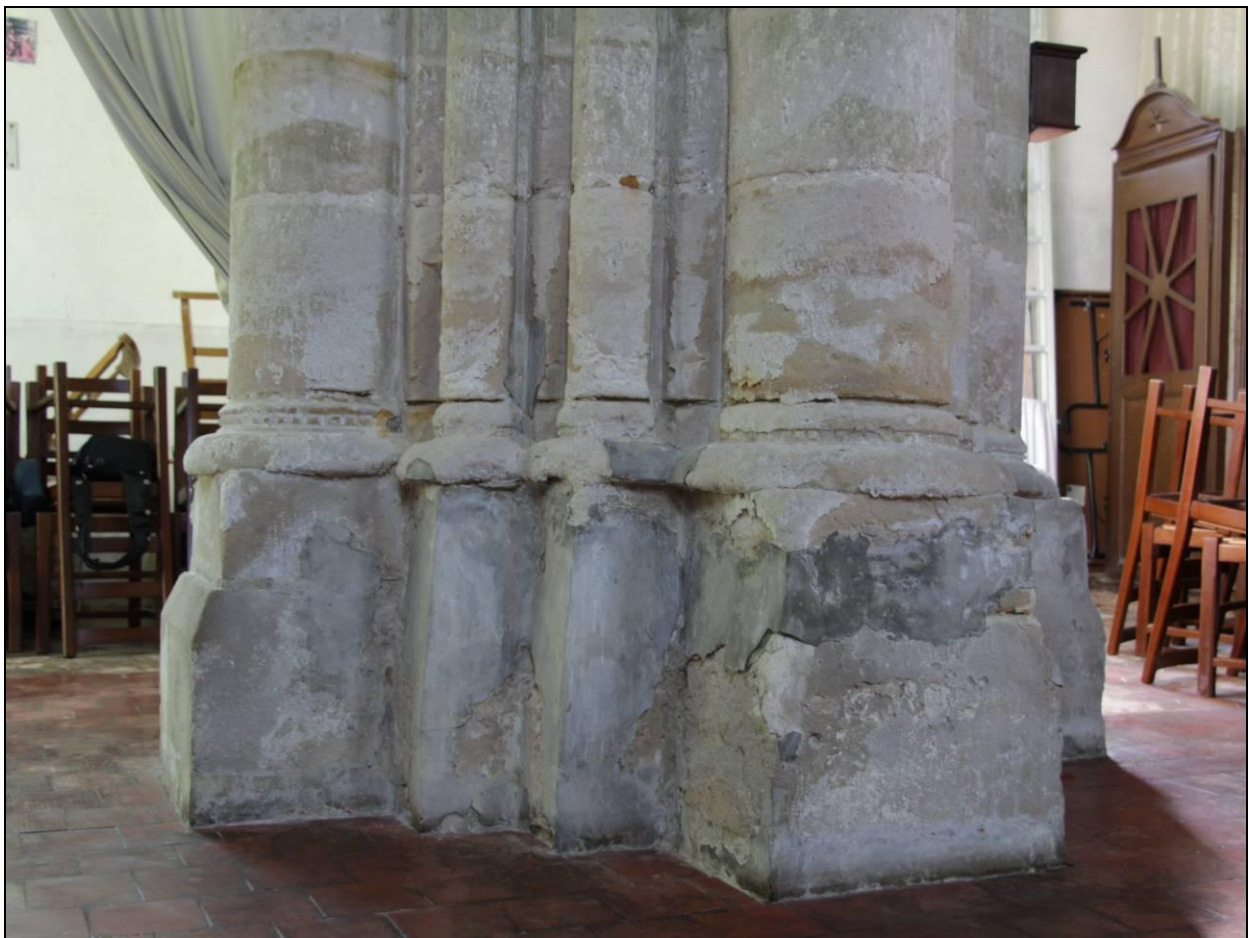
Base des piles Sud entre nef et collatéral : ragréages au ciment, blocs de pierre altérés.
