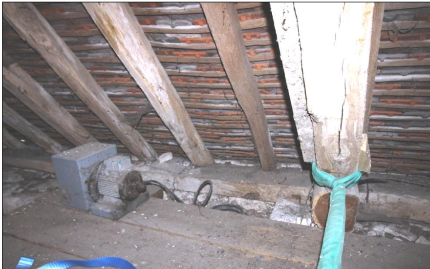
Le moteur de volée posé sur le plancher du beffroi. Photo CG 2018.
