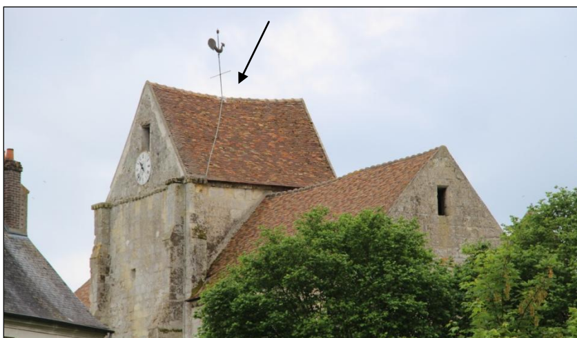
Affaissement du faitage, vu du côté Nord-Ouest. Photo CG 2018.
