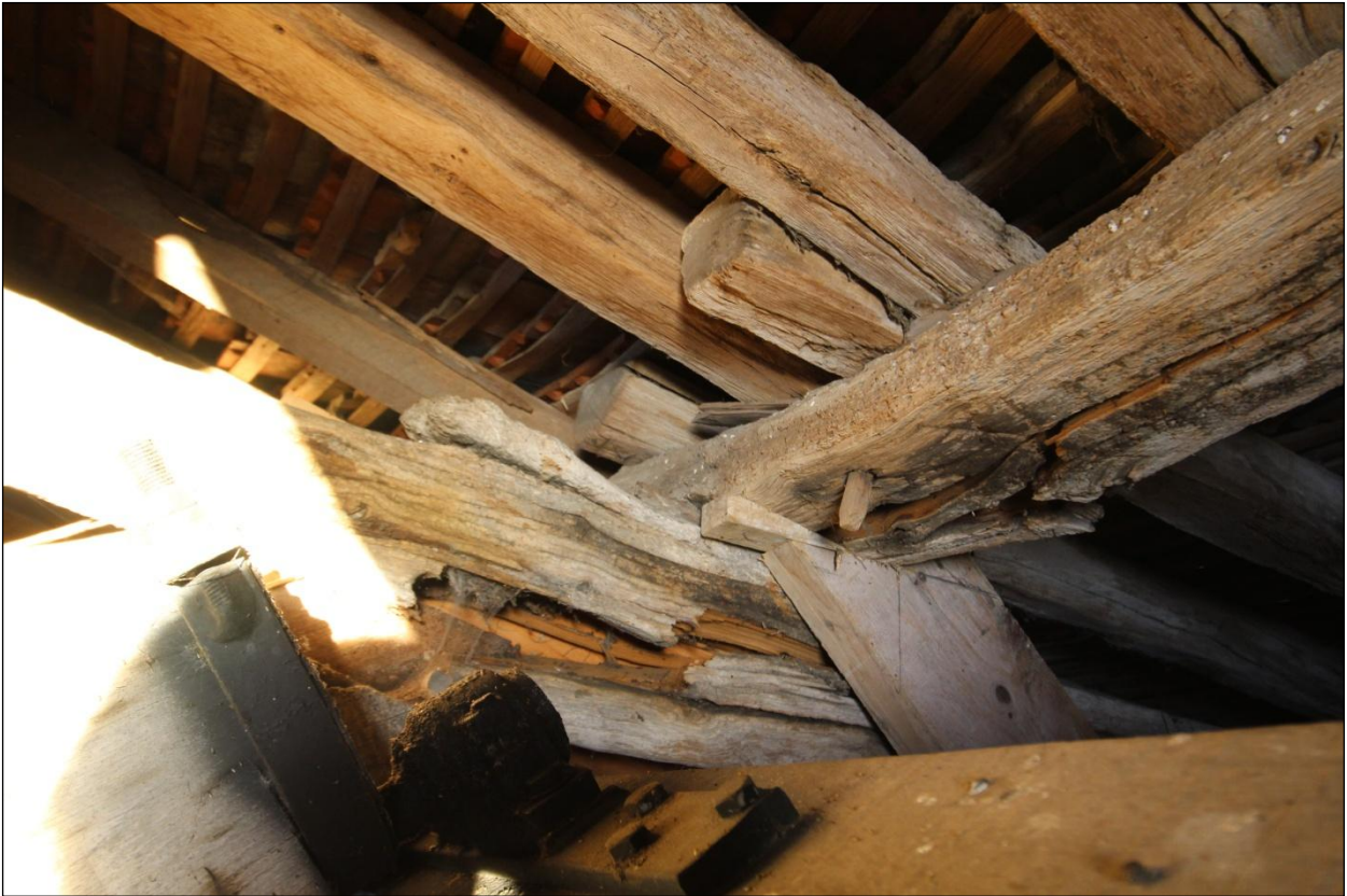
Détail de l'arbalétrier et de la panne cassée
