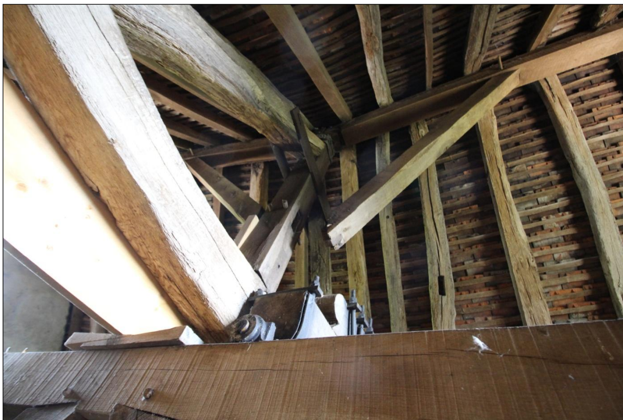
Charpente du toit disloquée. Lien entre faitage et poinçon arraché.
