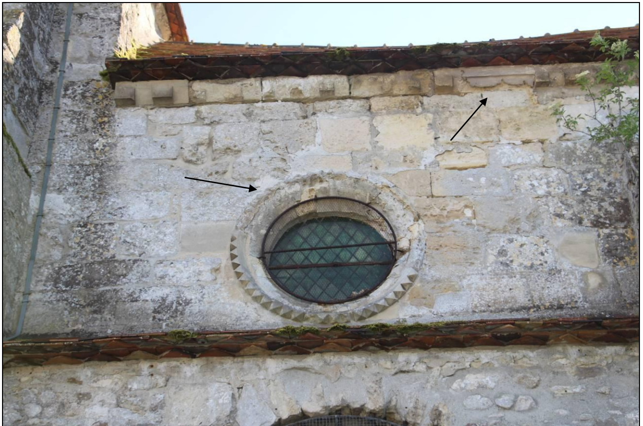
Travée 2, attenante au clocher. Sur corniche et encadrement de l'oculus : des blocs anciens très usés, des blocs remplacés en pierre de St Maximin au cours du XXe siècle, et des parties ragrées au mortier.
