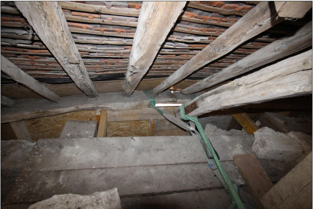
En l'absence d'entrait bas, la sablière – en deux parties assemblées - s'est déportée vers l'extérieur de près de 70 cm, poussant la corniche en pierre et le haut du parement extérieur avec. Photo CG 2018.
